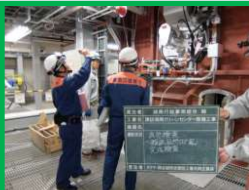
諏訪広域消防本部 (消火設備他)
